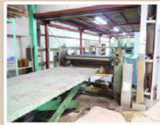
シーラー処理・塗装ライン
